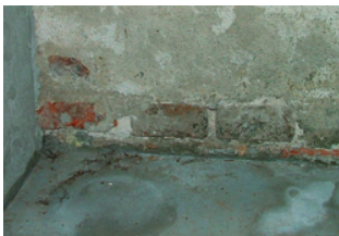
Feuchteschäden im Keller
